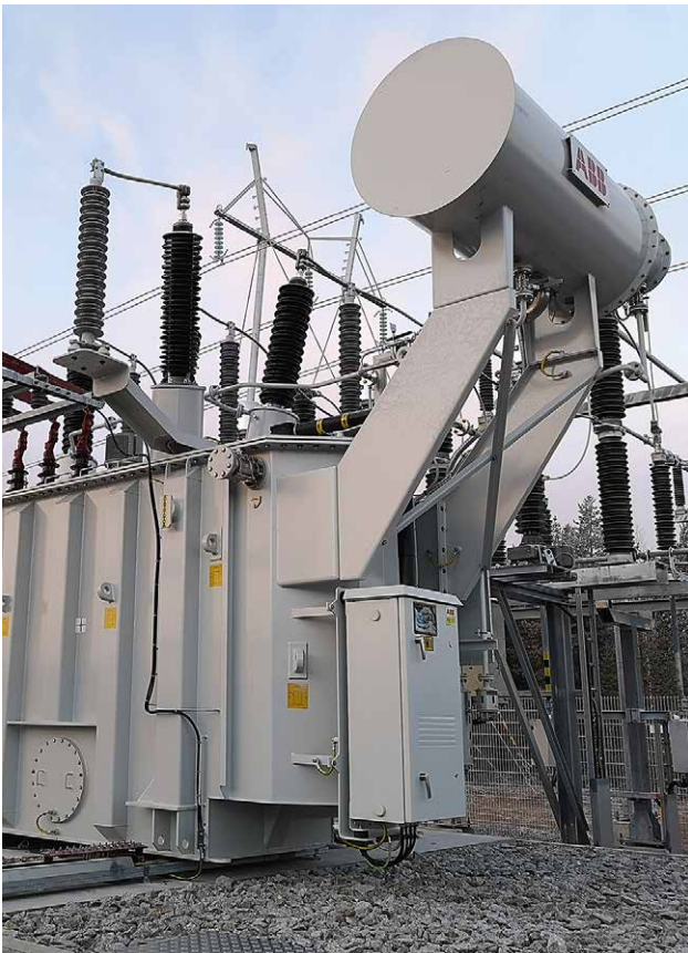
Sieppijärven sähköaseman päämuuntaja.
