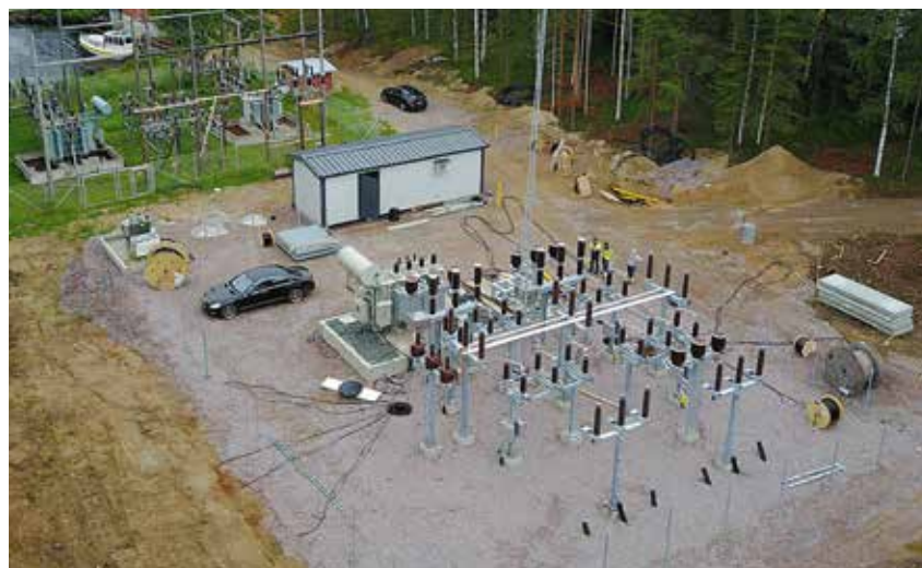
▲ Kaaranneskoskelle ja Jolmankoskelle rakennettiin uudet sähköasemat. Kuvassa Kaaranneskosken asema.
