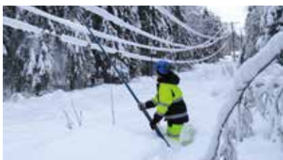
◀ Tykkylumen poistaminen linjoilta on välttämätöntä häiriöttömän sähköjakelun varmistamiseksi.
