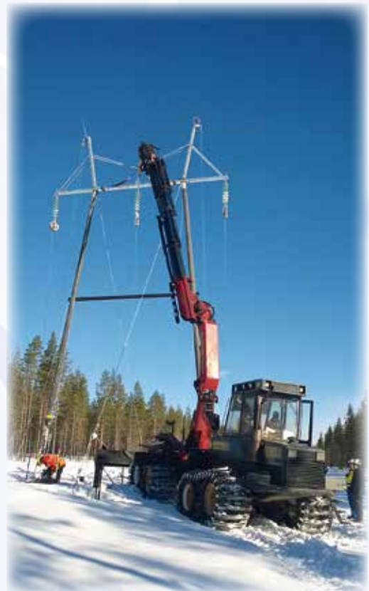
Kurtakko-Ylläsjärvi 110 kV -voimajohto
